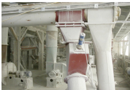
Rilevazione passaggio gesso a valle di una coclea
