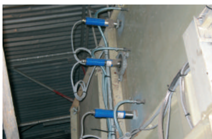
In cementificio per riempimento pre-hopper: livello minimo, massimo e super massimo.
